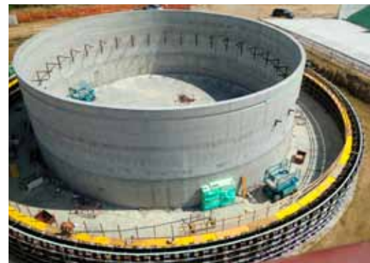
Implants Biogas - FACCHETTI COSTRUZIONI SPA
